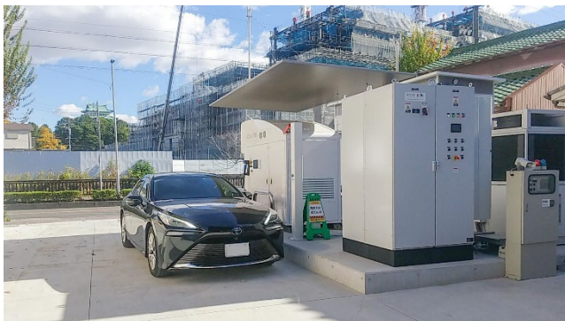
名古屋城グリーン水素ステーション
